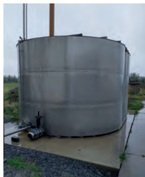
Cuve pour la récolte des eaux usées
