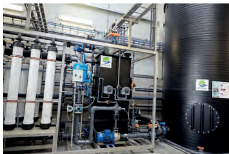
Systeme de purification des eaux pluviales
