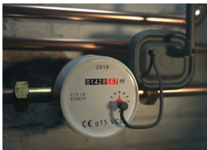
Boîtier de monitoring sur un compteur
